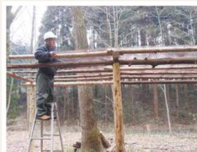
コナラ広場の小屋づくりの続き(今日は屋根づくりでした)
