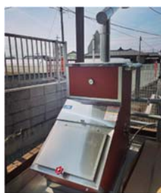
薪ボイラー(上)と薪ストーブ(右)
